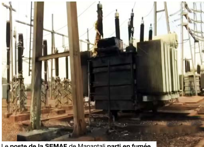
Le poste de la SEMAF de Manantali parti en fumée le 24 février 2026.
